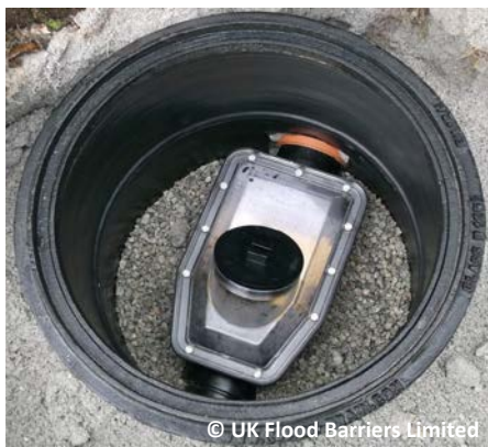
Terugslagklep in een nieuwe inspectieput: gesloten
