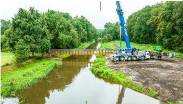
Plaatsing van de nieuwe voetgangersbrug over de Kleine Nete in het Olens Broek ©VMM
